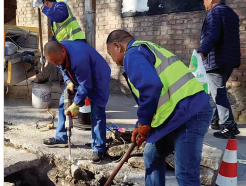
近日,沟社区网格员在排查安全隐患时,发现辖区内下水井井盖破损,影响居民出行安全,随即联系相关部门对破损井盖进行维修。
