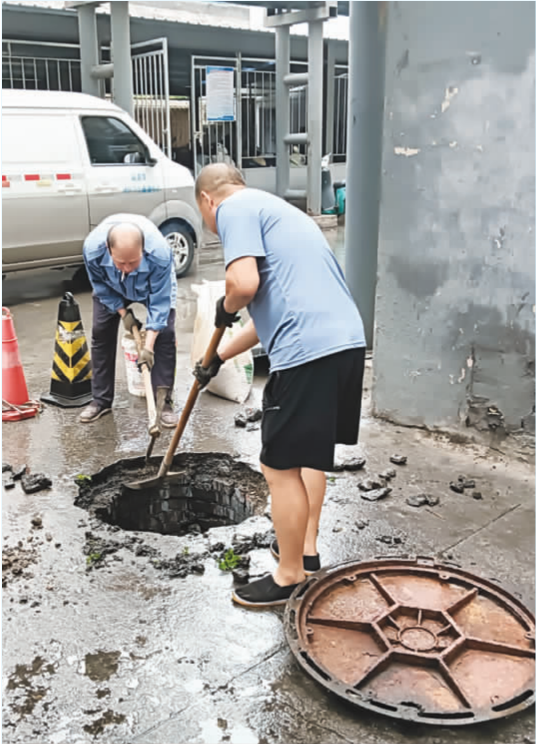
▲小南坑社区组织工作人员对辖区低洼地带、易涝积水重点部位进行隐患排查。 杨慧慧摄
